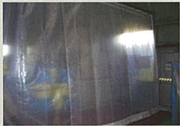
工場内間仕切り クリアシート
